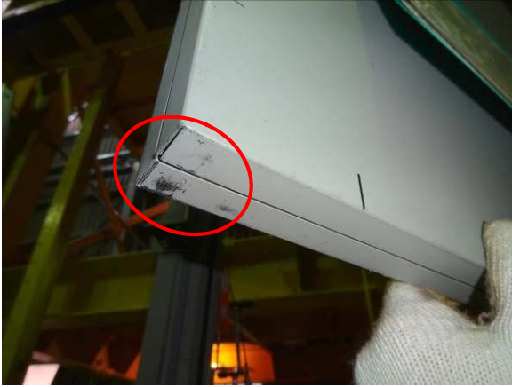
写真 13 戸先下側の擦りキズ (+1/60rad 除荷時)
