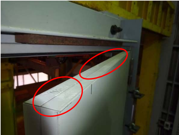
写真 15 戸先上側の擦りキズ (-1/60rad 除荷時)
