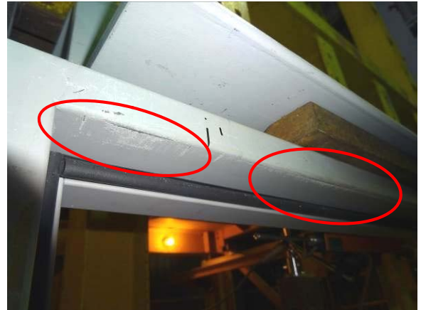
写真 16 上枠の擦りキズ (-1/60rad 除荷時)
